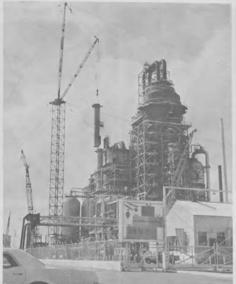
Un peso grandi ta ser hizá pa e grua di 307 pia haltu cual ta un seccion di schoorsteen di PCAR. Den como mei hora di maniobra cu habilidad, pa hiza y baha, e seccion yega sin peligro riba tera.
